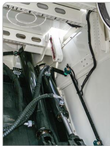
Wewnętrzne siłowniki płyty nośnej
